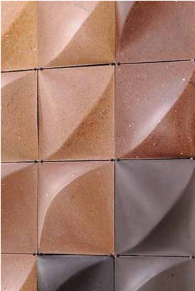
ตัวอย่างการตกแต่งผนังอาคารด้วย TRAshell (ที่มา www.itke.uni-stuttgart.de )
